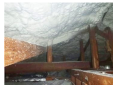
屋根裏の断熱リフォームの様子。 屋根裏、窓、床下の基本の3か所を押さえて(断熱リフォーム事例)
